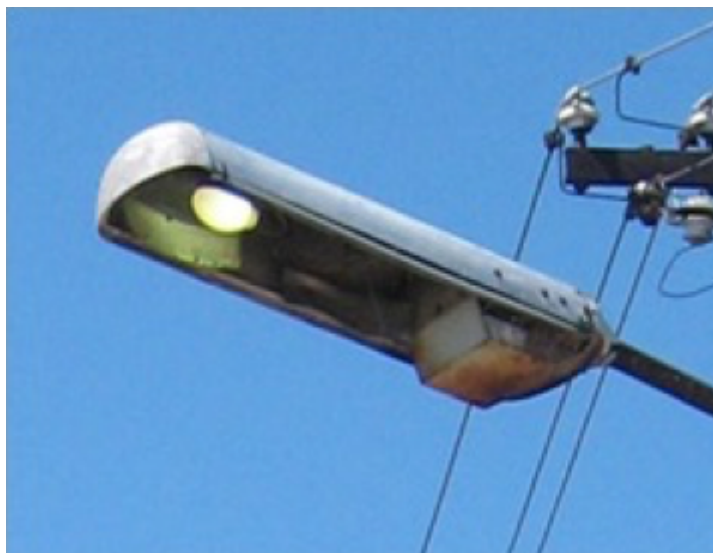
Obr.1 Poškodenie optickej časti svietidla
