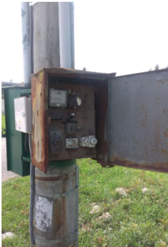
Obr.2 Korózia rozvádzača, chýbajúca spodná časť skrine rozvádzača
