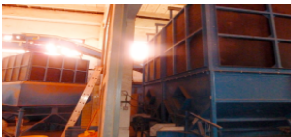
Obr. 20 Prechod z veľkoobjemového kontajnera do akumulčného zásobníka
