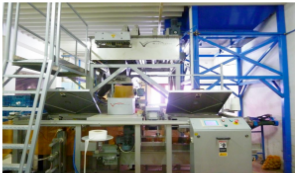
Obr. 32 Pohľad na novú linku časť váhy a baličky pre prané a neprané zemiaky
